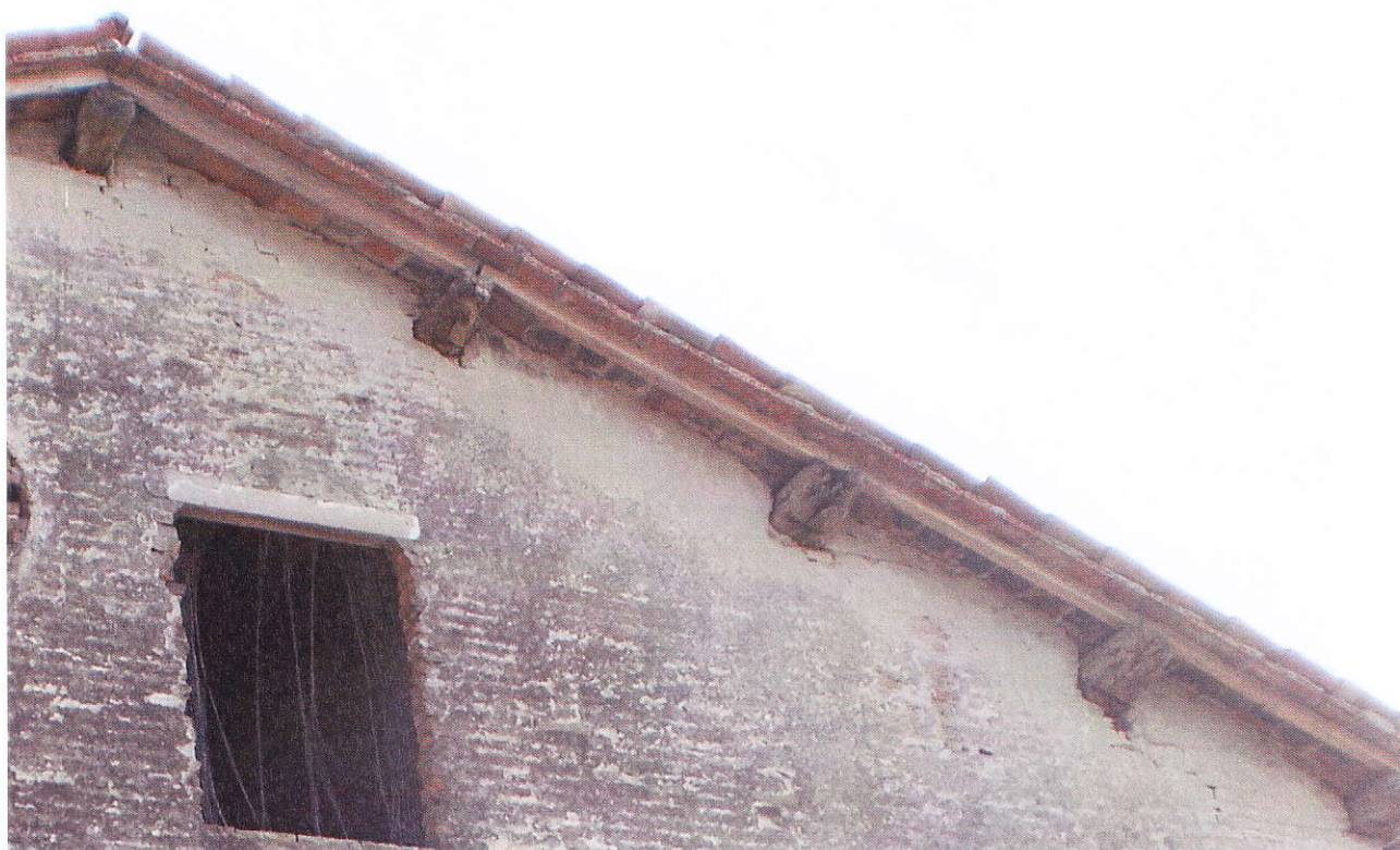
Foto 06: Particolare lesioni diagonali parete ovest in corrispondenza dell'appoggio delle travi copertura
