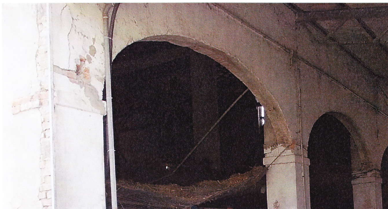
Foto 01 : Profonde lesioni sub-orizzontali passanti che interessano l'intero spessore del pilastro in corrispondenza dell'imposta degli archi
