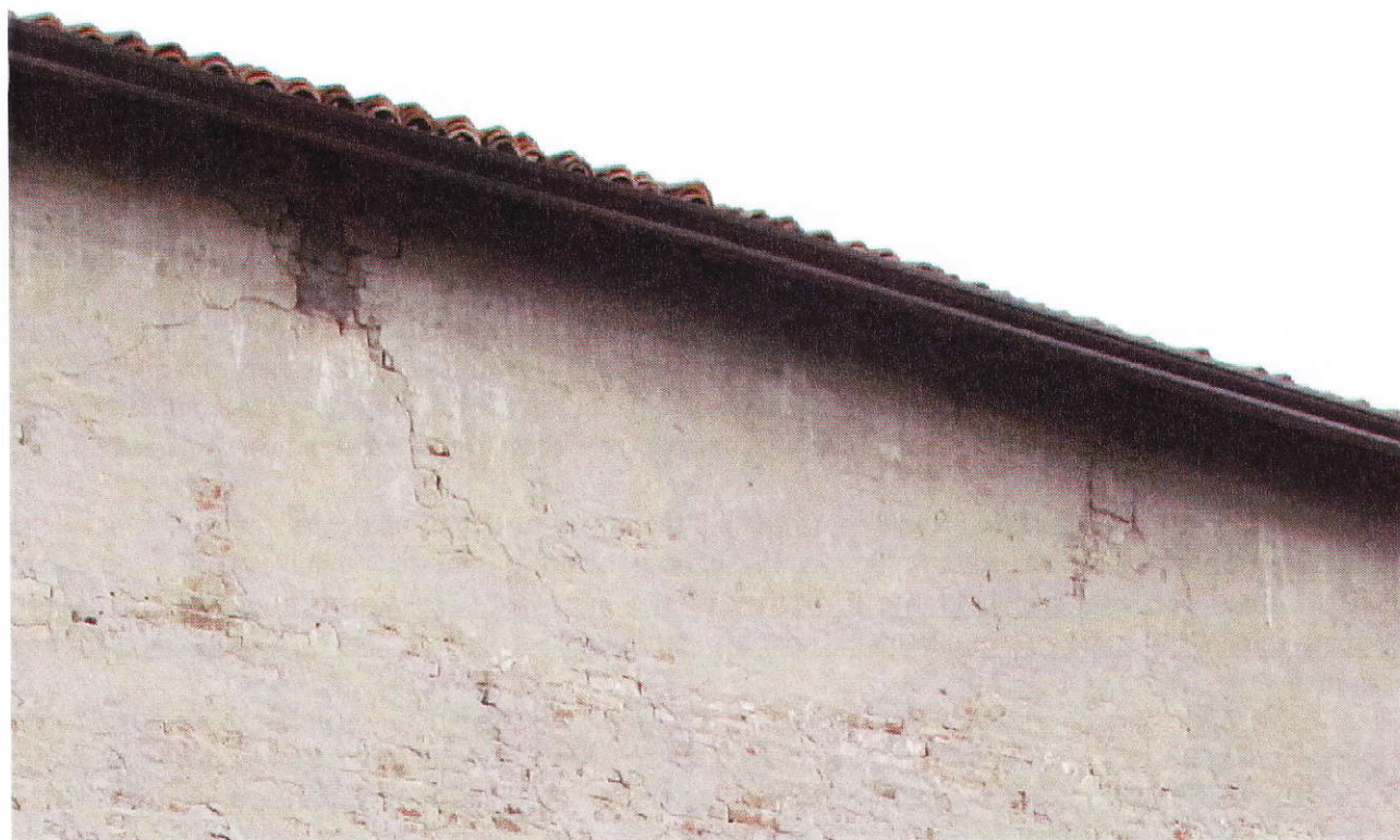
Foto 07: Particolare lesioni diagonali parete ovest in corrispondenza dell'appoggio delle travi copertura
