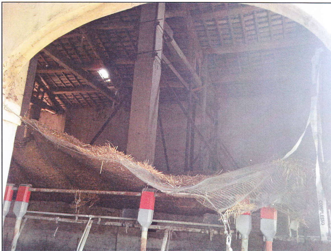
Fig. 7: Danni agli appoggi ed alla struttura della copertura.
