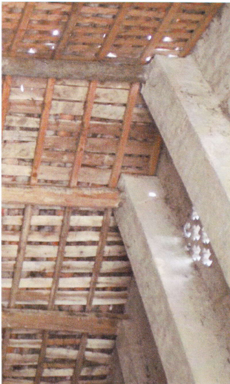
Foto 05 : Elevati fuori piombo pilastri perimetrali lato sud
