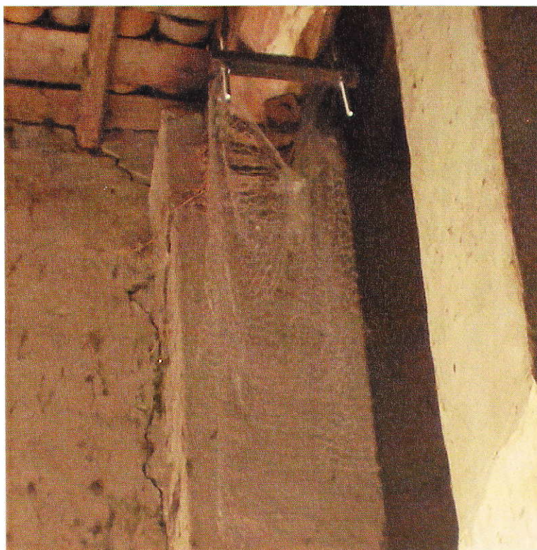
Foto 04: Lesione in testa al pilastro e in corrispondenza dell'appoggio della trave di copertura e dell'ammorsamento con la parete
