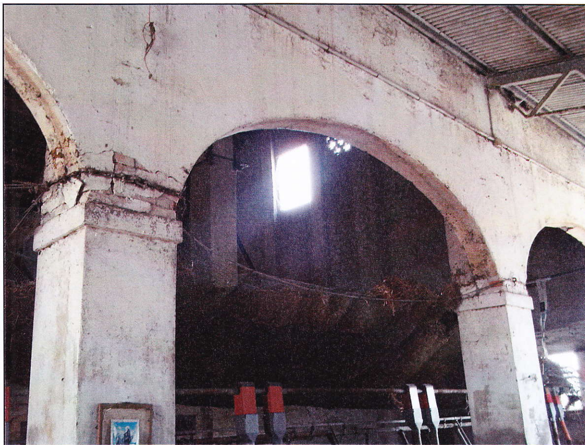
Fig. 10: Lesioni orizzontali passanti in corrispondenza della base di imposta dell'arco ribassato del portico.
