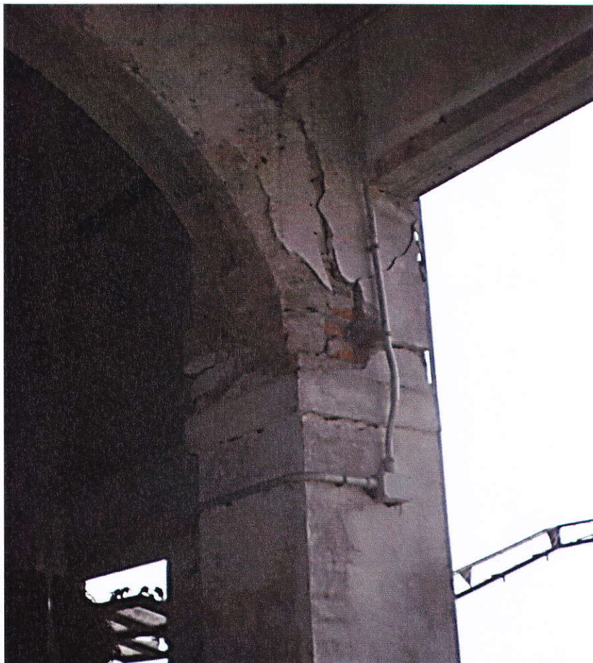
Foto 03: Grave lesione passante che interessa l'intero spessore del pilastro di spigolo nord-est
