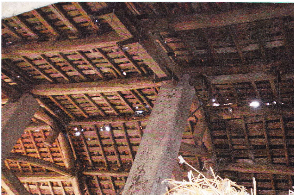
Foto 08: Stato copertura, perdita di verticalità testa del pilastro in corrispondenza dell'appoggio della capriata. Nel manto di copertura evidenti scostamenti tavole lignee e coppi di copertura
