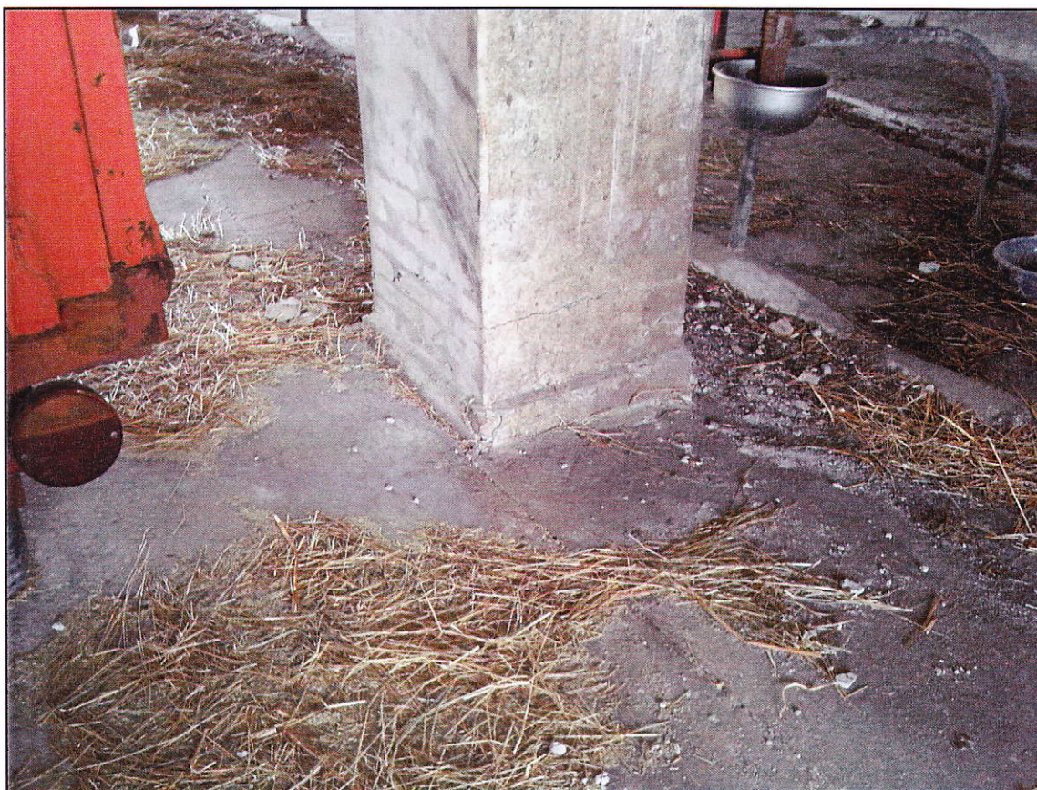
Fig. 8: Lesioni orizzontali passanti in corrispondenza della base dei pilastri portanti del portico.
