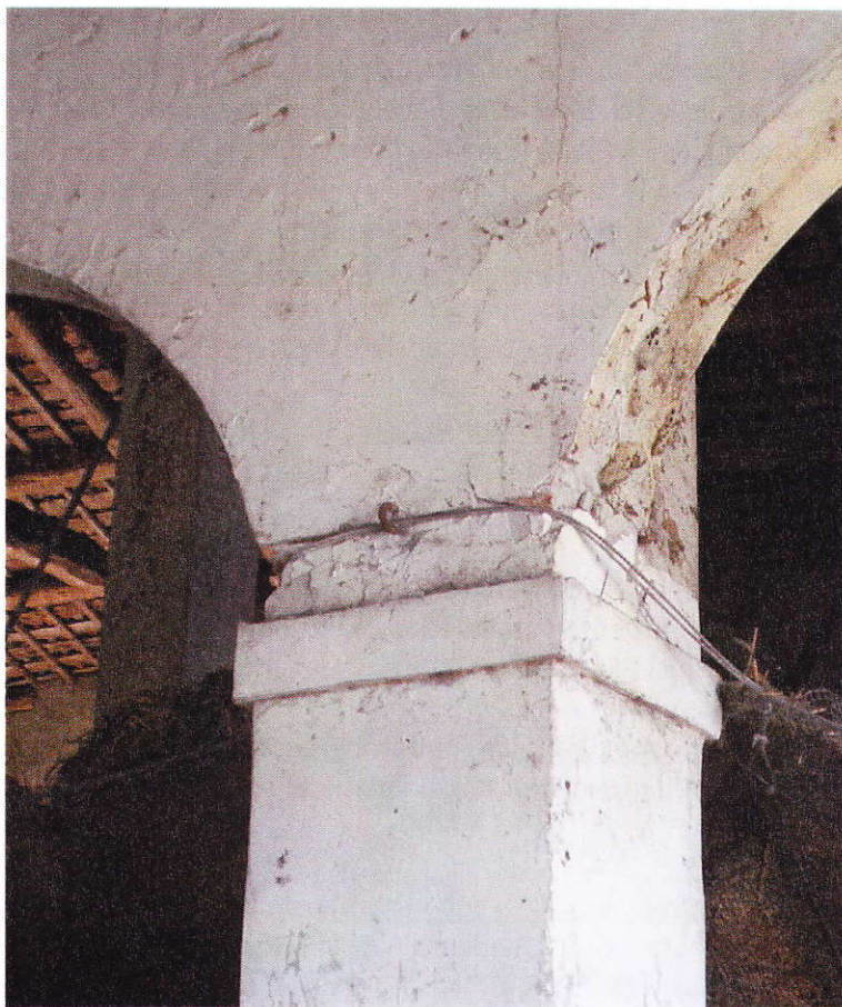
Foto 02 : Particolare lesione su pilastro lato est. in corrispondenza imposta degli archi ribassati
